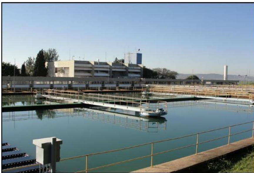
Figura 10: Decantadores da ETA 03. Fonte: SANASA (2021).
