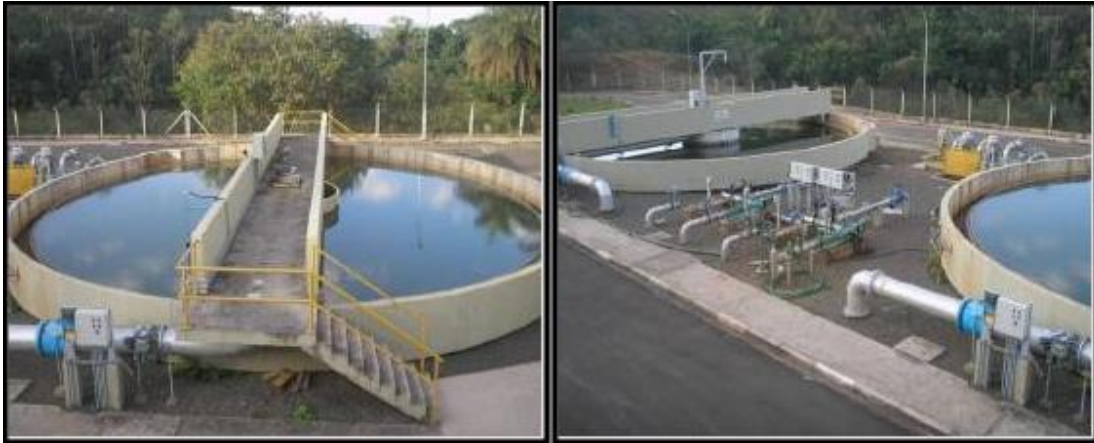
Figura 16: Adensadores por gravidade instalados na ETL das ETA 3 e 4 da SANASA na cidade de Campinas. Fonte: SANASA (2021).
