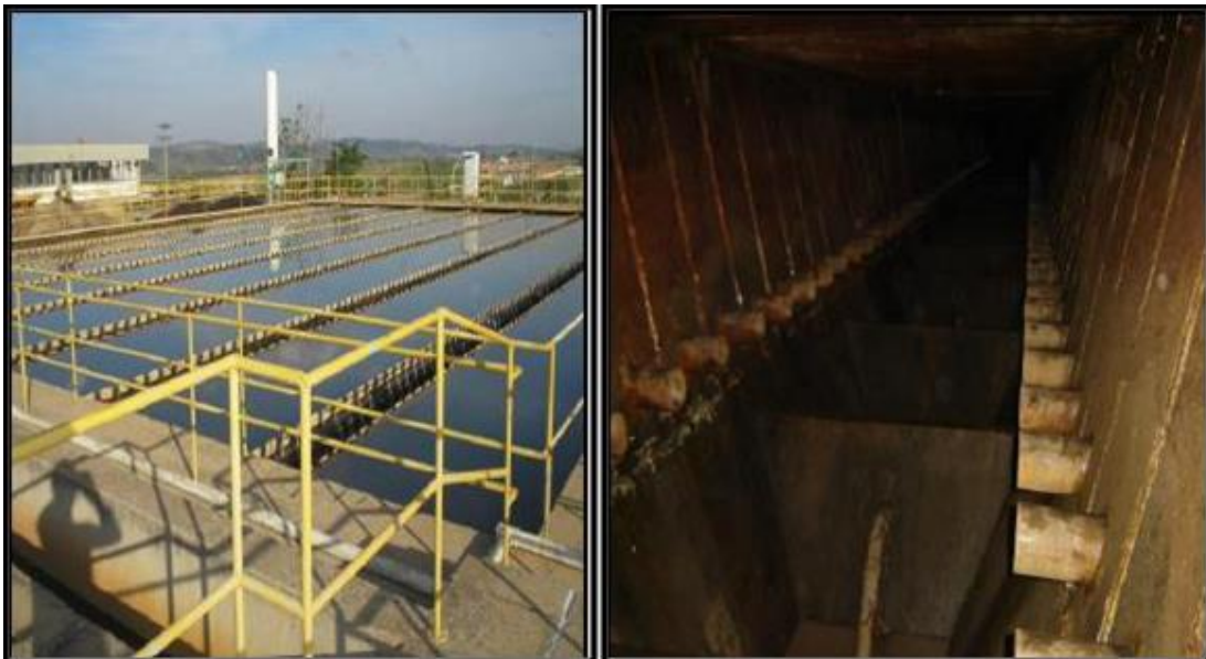
Figura 11: Área Superficial do Decantador da ETA 04 (Esquerda). Parte Interna do Decantador (Direita). Fonte: SANASA (2021).
