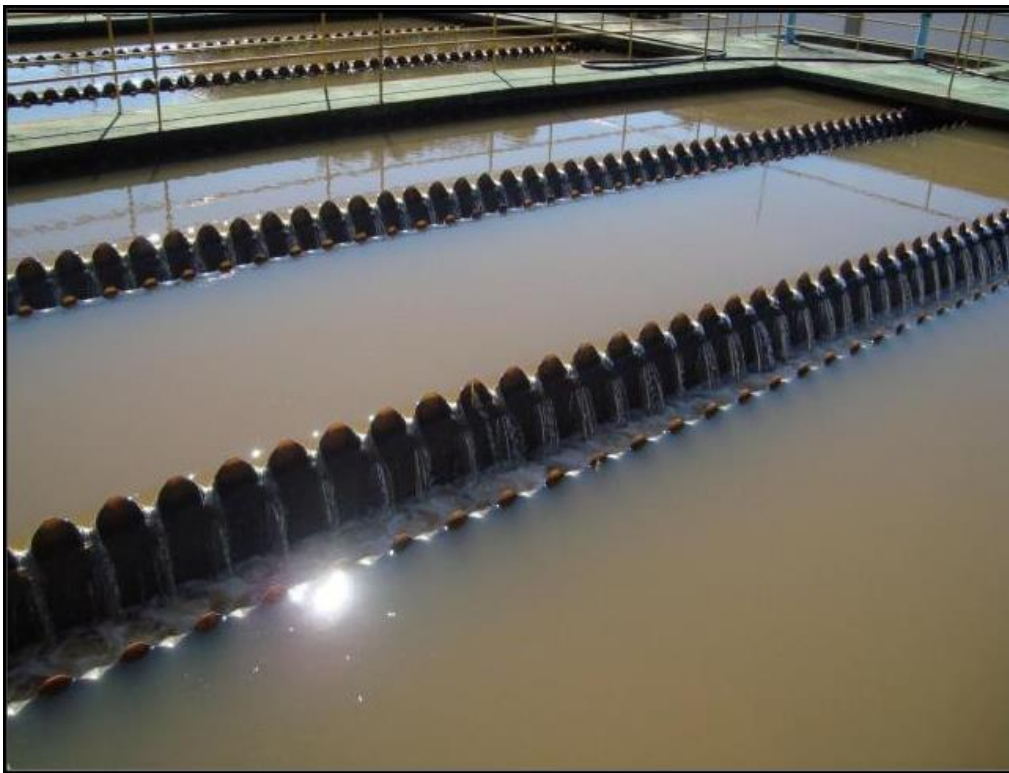
Figura 8: Pré-sedimentador de Fluxo Ascensional das ETA 03 e 04. Fonte: SANASA (2021)
